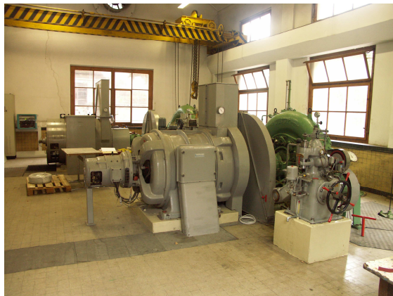
Centrale actuelle du Bévieux, salle des machines
