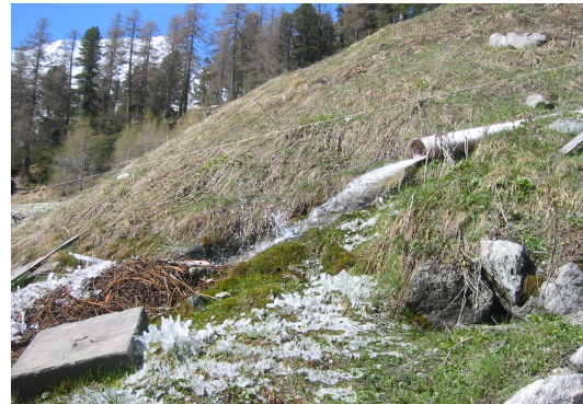
Figure 2 : Exutoire d'eaux usées et d'ECP
