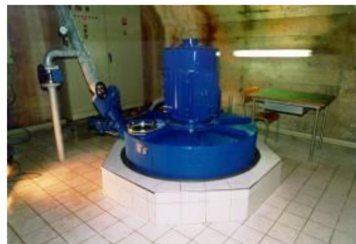
Figure 2 : Turbine de Savatan de 55 kW
